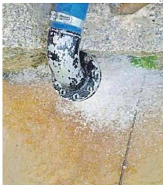
Manguera de fecales de la estación de bombeo de Vilariño.
