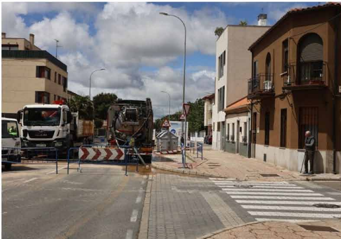
El tramo afectado por el reventón.
