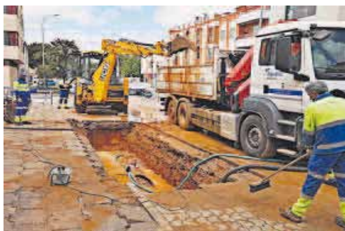
Operarios de Aqualia trabajan en el reventón. FOTOS: ALMEIDA
