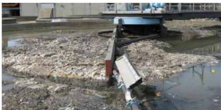
Restos de toallitas y textiles en una estación depuradora de aguas residuales
